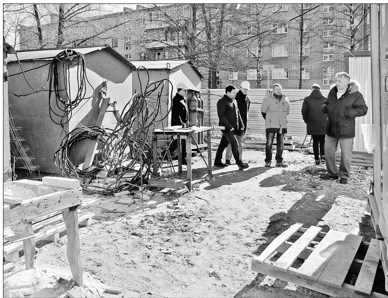
Нарушения не устранены.
