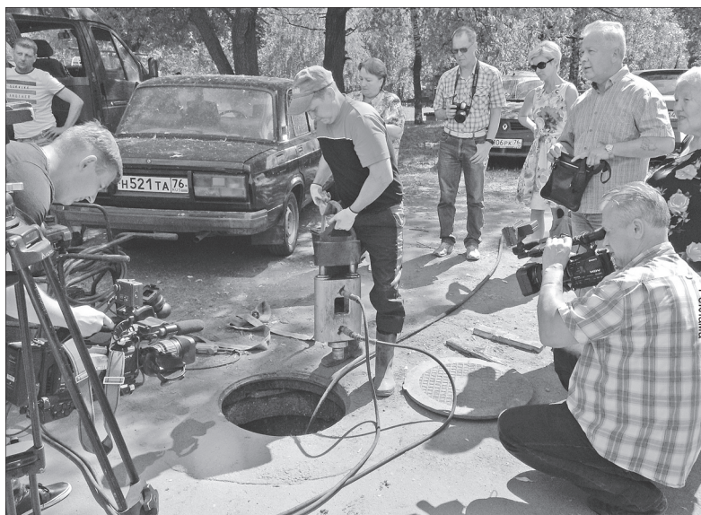
В колодец опускается тяговое устройство, которое за час прокладывает новую трубу на место старой.
