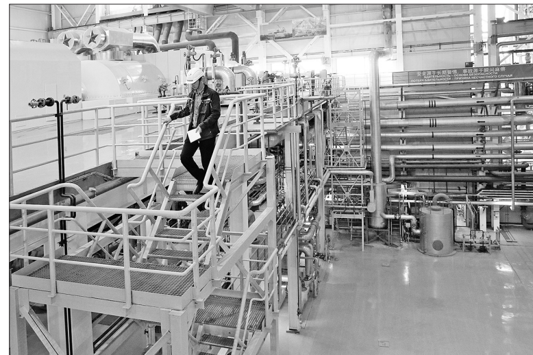
Турбины Хуадянь-Тенинской ТЭЦ позволяют на четверть сократить потребление топлива.
