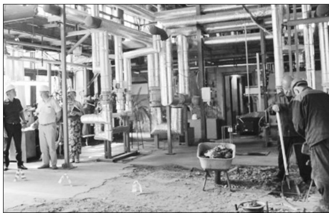
В котельной поселка Прибрежный.
