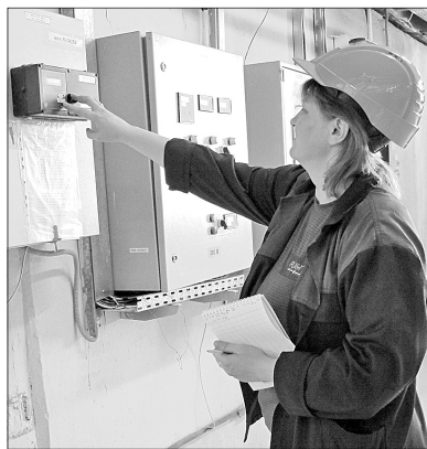
В котельной установлено современное оборудование.
