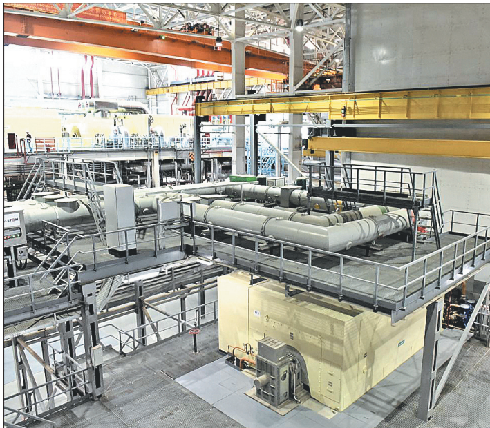
ТЭЦ будет обеспечивать теплоэнергией значительную часть Дзержинского района.
