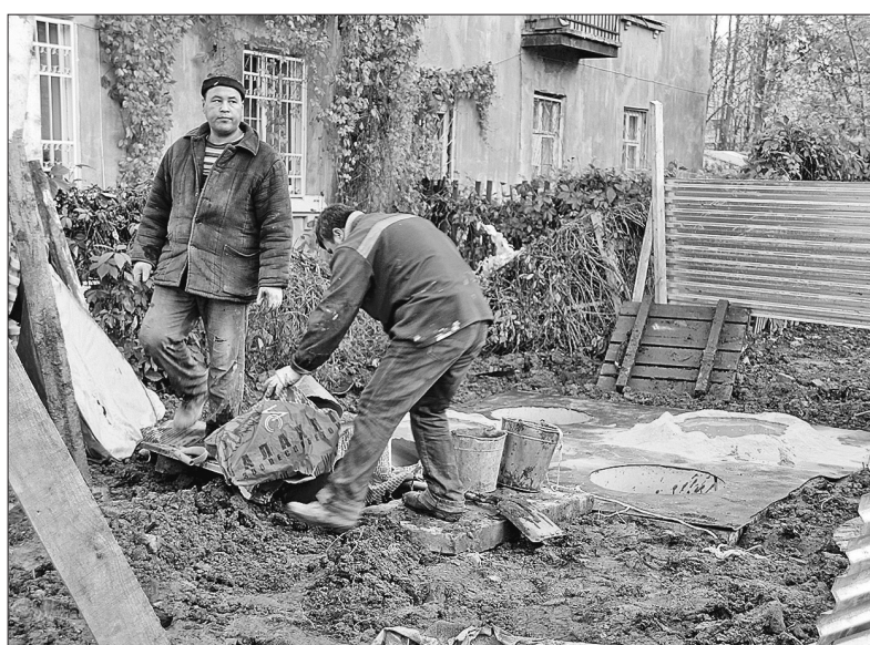
Во дворе на Жукова не завершены строительные работы.
