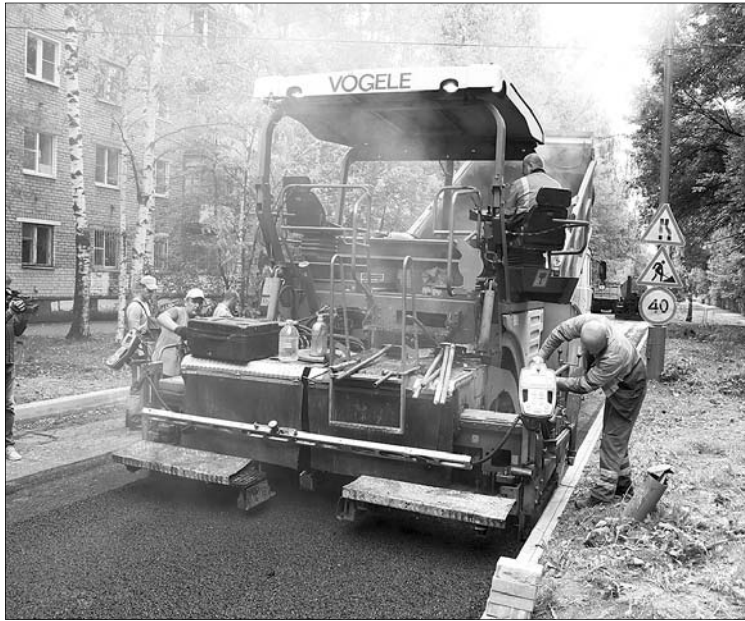
Улица Тургенева. Работы ведет ООО «Дорожное управление», г. Вологда. Здесь рабочие укладывают выравнивающий слой асфальтобетонного покрытия. Завершение работ – 1 сентября.
