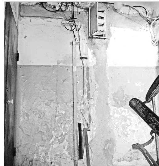
Провода вьются по всему дому.
