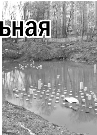
На ул. Институтской, 13 котлован заполнен водой.
