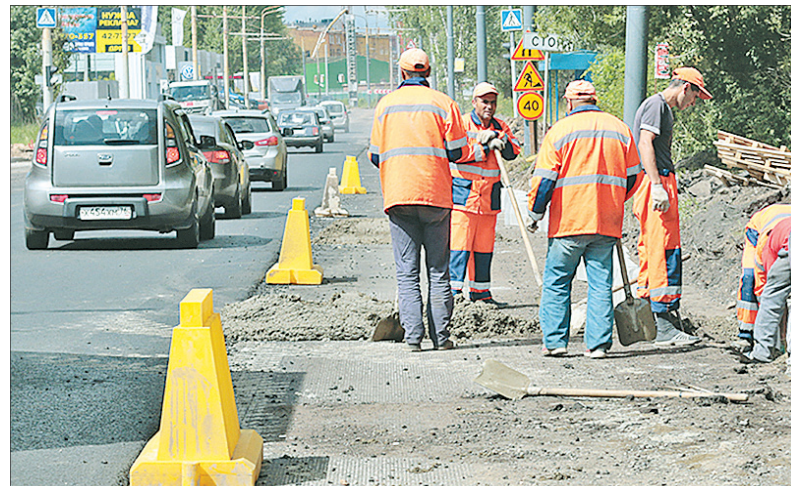
По укладке бордюрного камня есть замечания.
