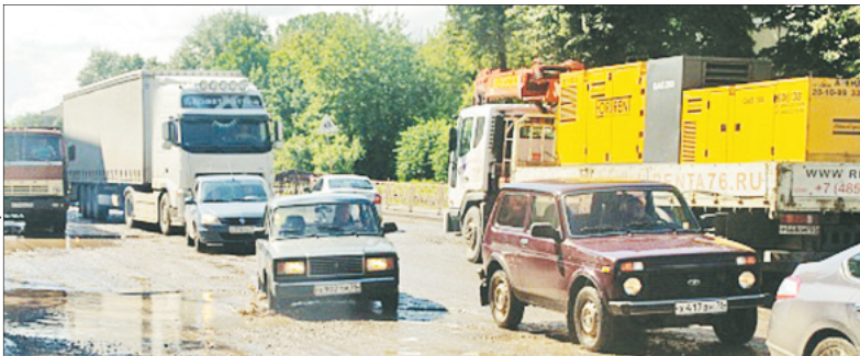
Отфрезерованные участки начинают разрушаться.
